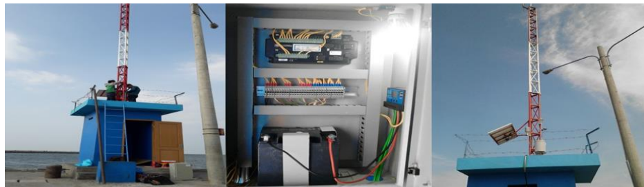
Instalasi AWS Pelabuhan Sabang
